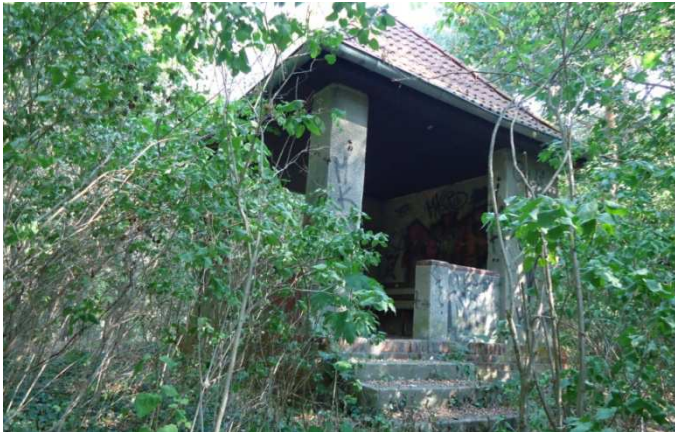
Der ruinöse Pavillon ist im Besitz der privaten Asklepios-Klinik. Der Blick auf die Stadt ist verwachsen, 2017, Foto d. A.
